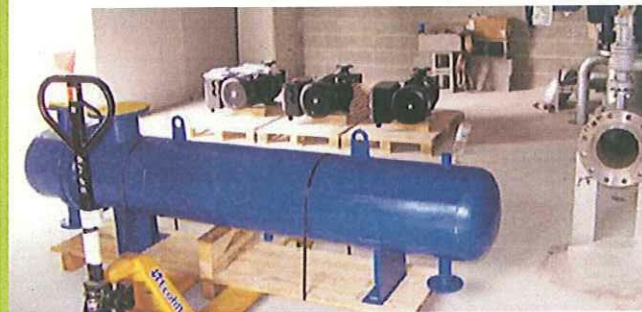
Scambiatore di calore a fascio-tubiero vapore-acqua per teleriscaldamento (2.4 MW)
